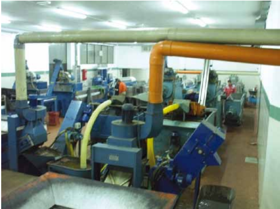
Fig. 11 -Tubazioni aeree per l'allontanamento delle foglie
