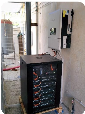
inverter ibrido - batterie
